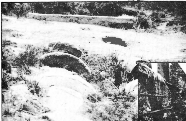
La carretera de Guane a Mantua al pasar por sobre una alcantarilla de doble tubo.
